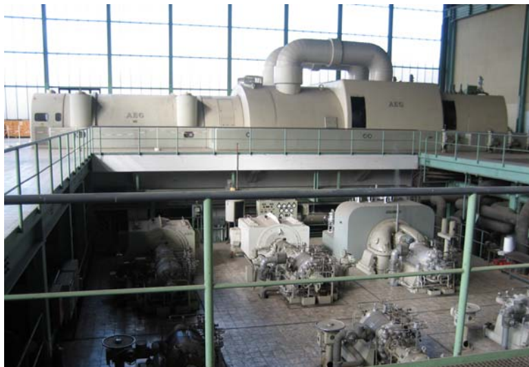
Машинный зал эл.станции Wallheim, Германия, построенной AEG.
