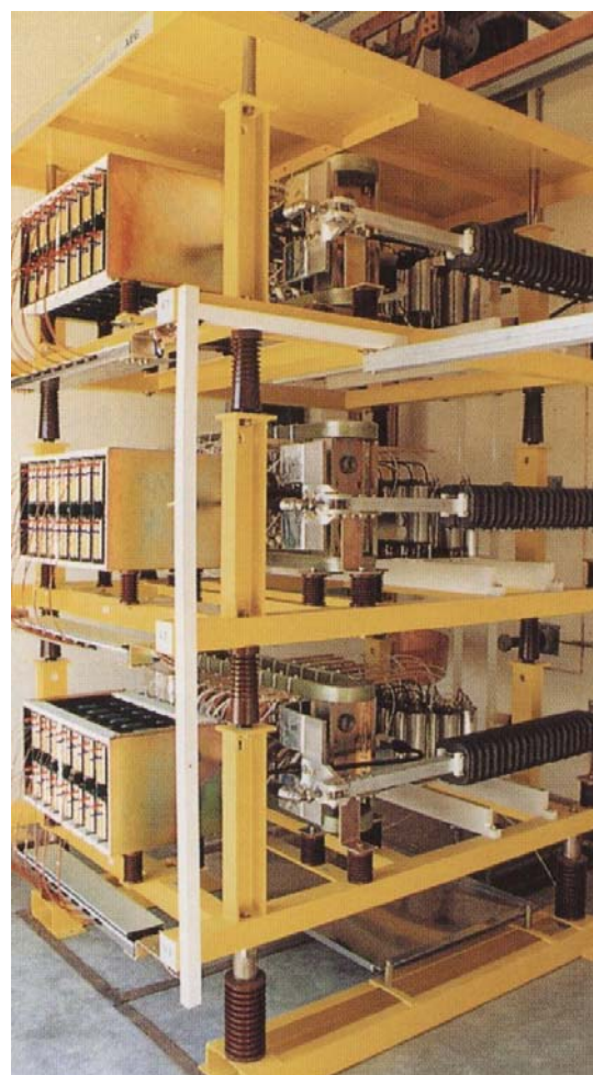
Zur Steuerung und Regelung elektrischer Ströme sind - ähnlich wie bei Rohrleitungssystemen für flüssige Medien u. a. Ventile erforderlich. Das hier wiedergegebene wurde als dreiphasiges Thyristor-Ventil (TCR- Ventil) für Leistungen bis 60 MVar ausgelegt und gehört zu einem von der AEG entwickelten Stromrichtersystem
