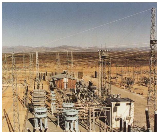
Umspannungstation Omburu mit der Blindstrom-Kompensationsanlage der AEG.
