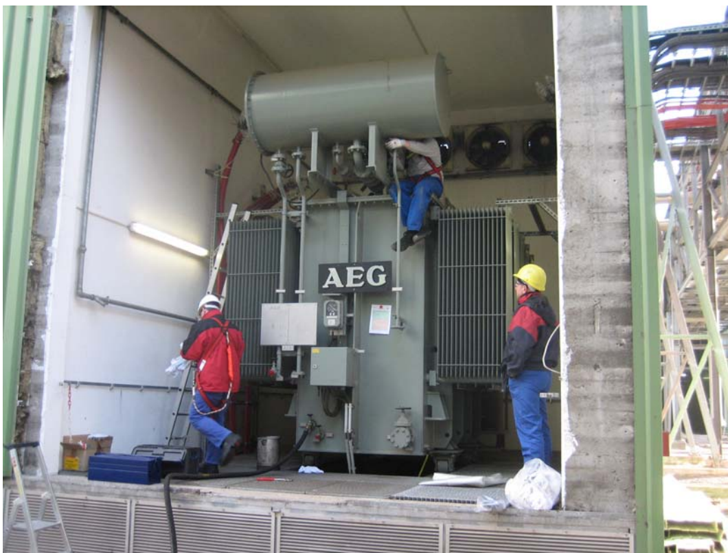
Zdjęcie 7 Odłączenie połączeń konserwatora
