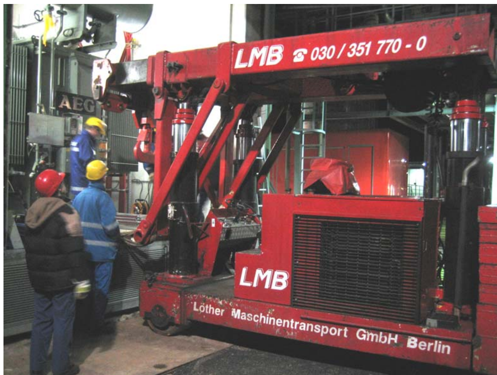
Zdjęcie 11 BOOM-TRUCK przed pomieszczeniem transformatora.
