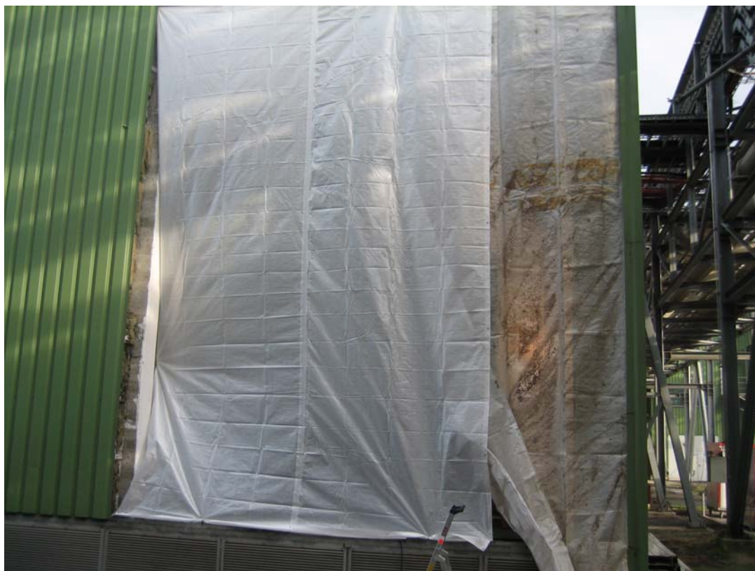
Zdjęcie 9 hala transformatora osłonięta folią
