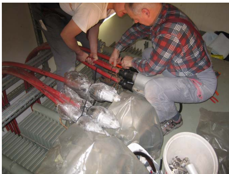
Zdjęcie 36 Obustronne podłączenie transformatora
