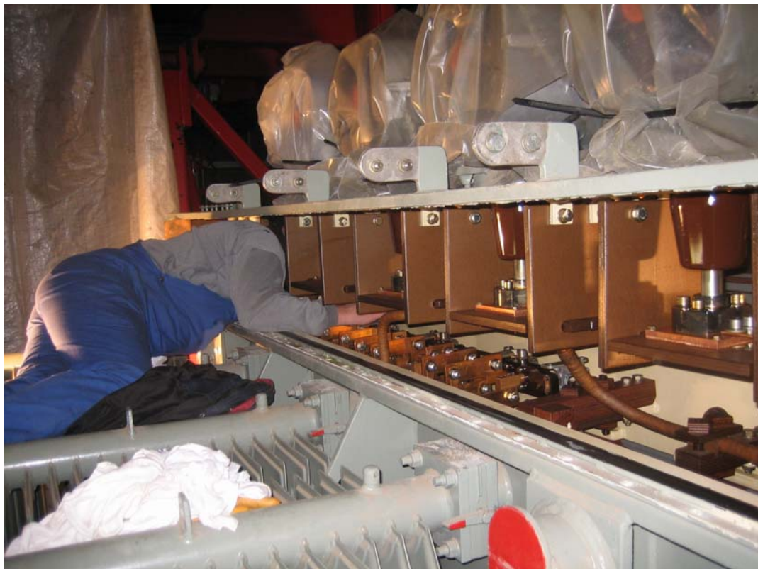
Zdjęcie 19 Dokładna kontrola przełącznika
