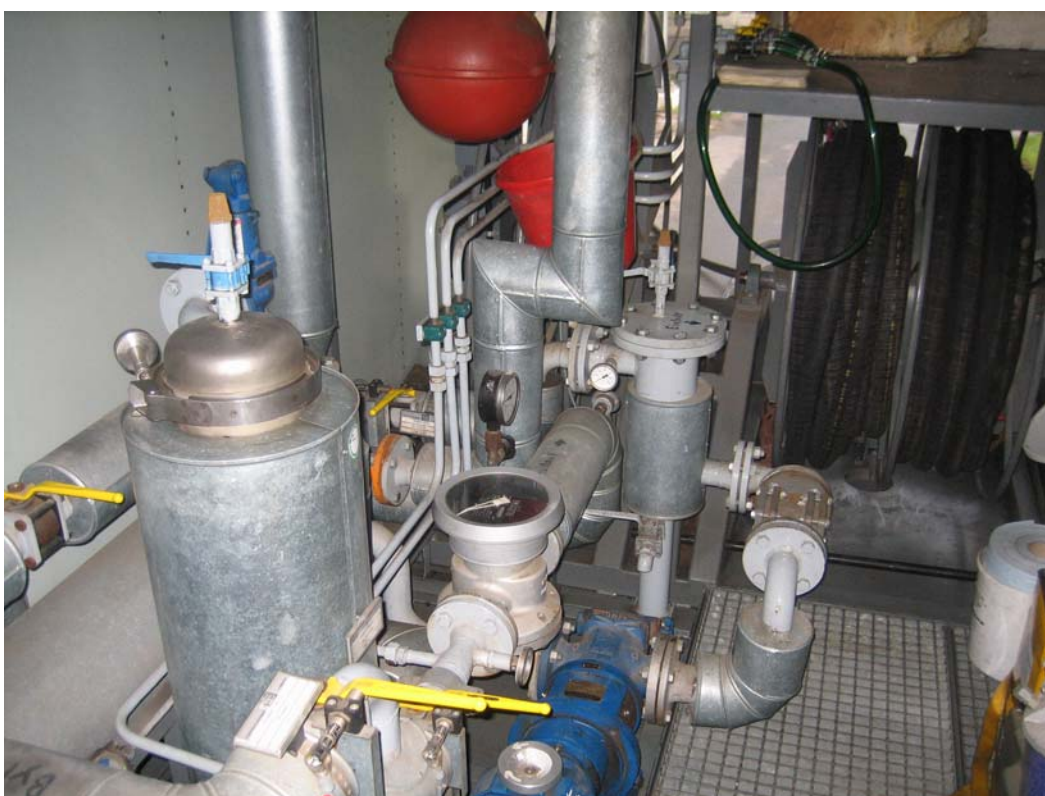
Zdjęcie 5 Instalacja do obróbki oleju
