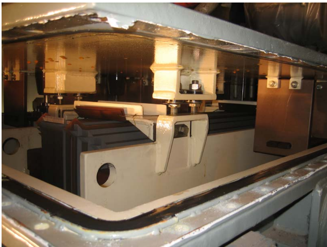
Zdjęcie 17 Otwarty transformator – widok na część aktywną
